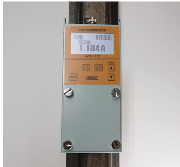
レール電流測定
